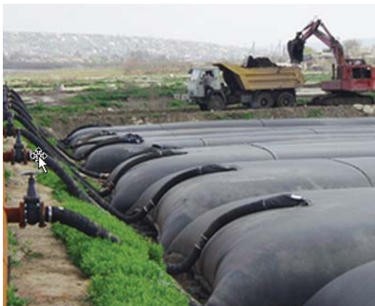
Фото. 1. Общий вид геотубного участка на очистных сооружениях
