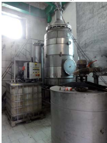
Рис. 5. Общий вид многофункционального пилотного биогазового реактора на заводе компании В.Т.ЕСТ&СО (бывш. завод «Alimentarmaș», Кишинев)
